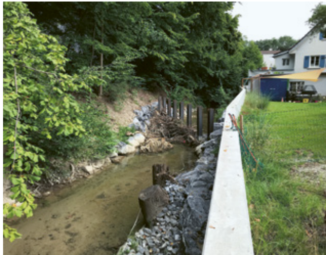
Der Hochwasserschutzrechen beim Schäflibach in Urdorf
